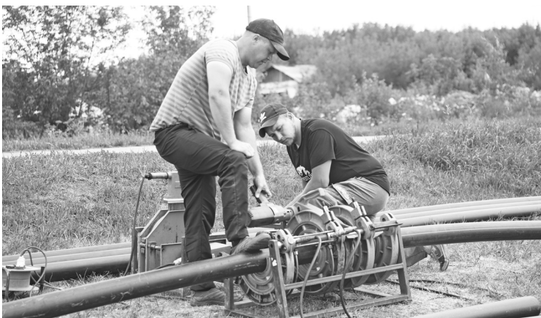
Слесари-сантехники Владислав Пинигин и Иван Борисов спаивают водопроводные трубы, превращая их в стометровые плети
