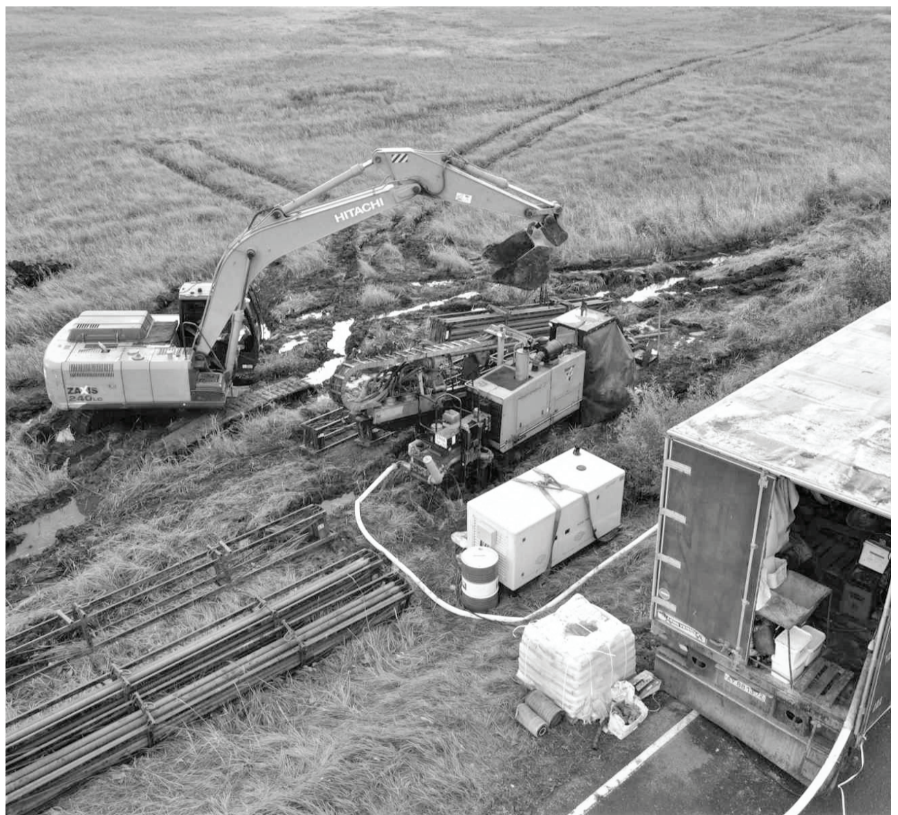
Строительство водовода позволит решить актуальную проблему – обеспечение питьевой водой жителей посёлка Маслянский. //Фото администрации района
