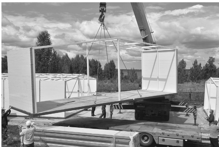
Станцию водоочистки в райцентре построили в прошлом году
